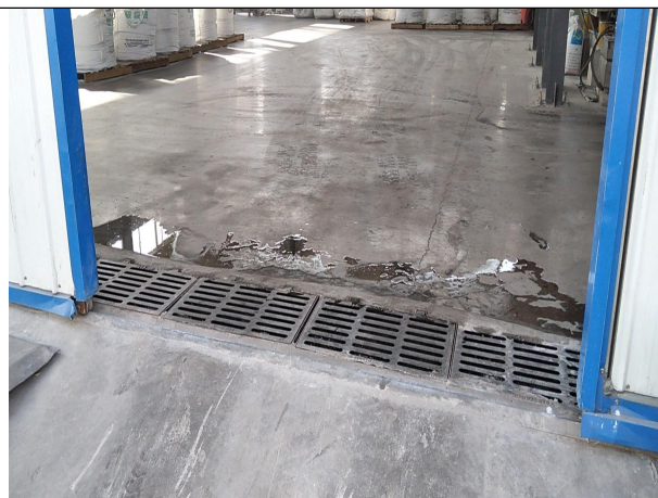
碳酸锂车间事故水截留渠
